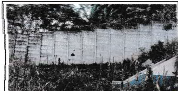
Foto 4: Muro perimetral deteriorado.
