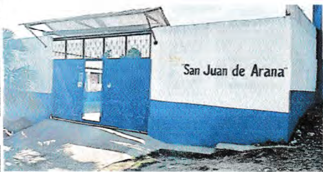
Foto 1: Pintura en mal estado del muro exterior como de porton.
