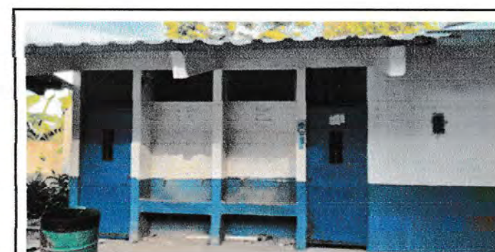
Foto 6: Lavamanos de cemento deteriorados.
