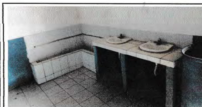
Foto 5: Lavamanos y urinarios de cemento en mal estado.
