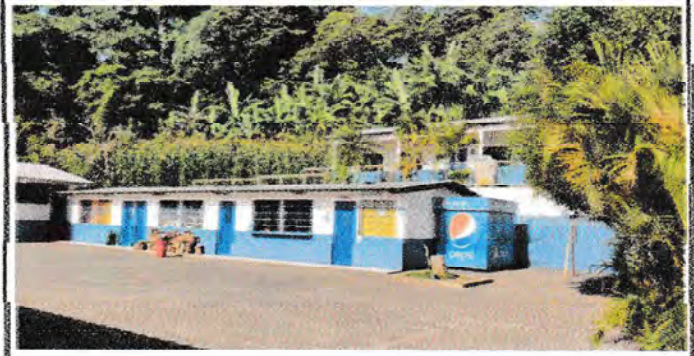
Foto 2: Pintura de paredes en mal estado del interior del centro educativo.
